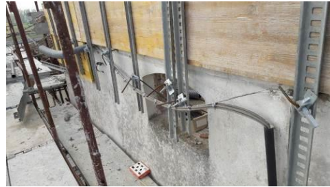
Linee isolate poste in facciata
