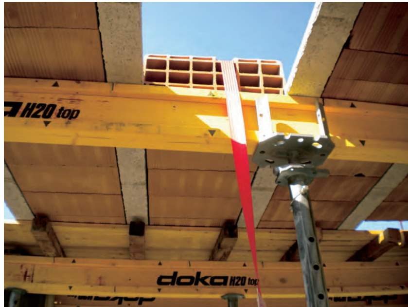
Figura 36 - Rottura locale e marginale della pignatta sotto il carico dinamico della caduta del manichino prova
