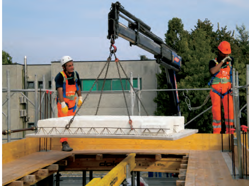
Figura 41 – Operai nella posa della prima lastra con imbracatura anticaduta e cordino agganciato al ponteggio di facciata.
